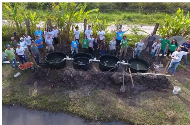
Figura 34 – Implantação das tecnologias de saneamento rural com a participação do Projeto Plantando Águas
